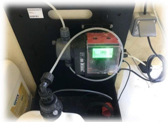
Pompe doseuse de chlore
